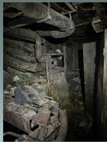
Εικόνα 3: Χώρος Κλιματιστικής μονάδας
